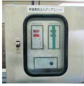
塩素剤注入ポンプユニット
