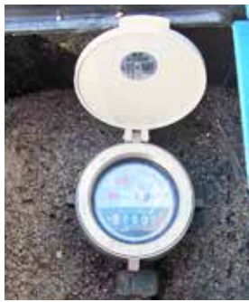
水道メーター
