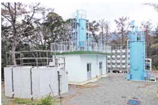
整備後の轟木浄水場
