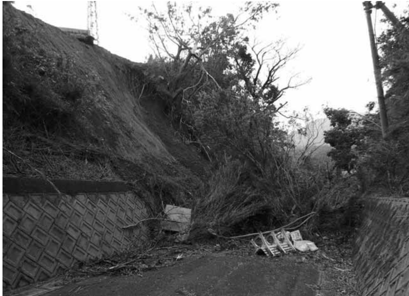
がけ崩れで通行できなくなった道路（花徳）
