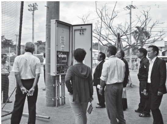
亀津中学校屋外照明機器
