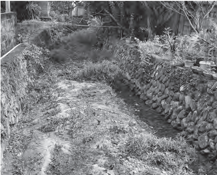
土砂の堆積した河川（母間地区）
