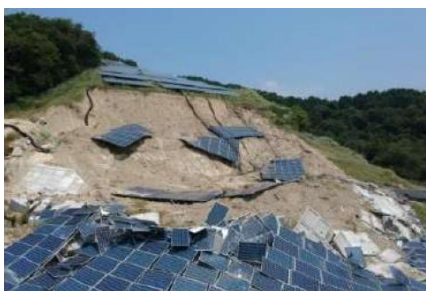
災害に起因した太陽光発電設備に係る被害例
