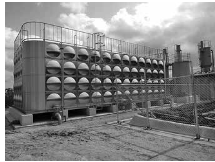
整備された母間浄水場
