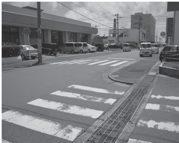
土砂で埋まっている鹿児島銀行前の側溝
