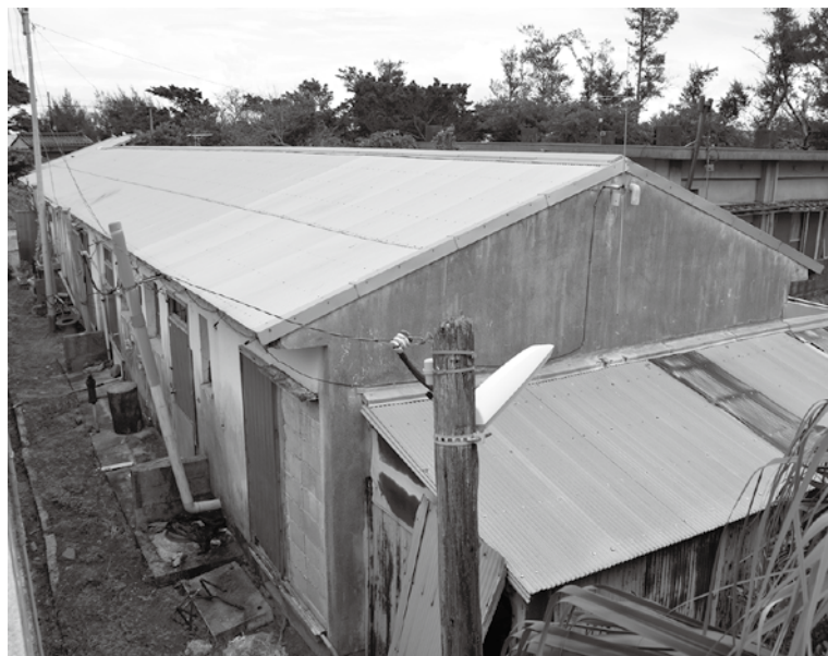
建て替え予定の町営住宅（山地区）
