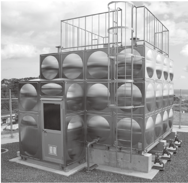
容量が40トンの給水施設
